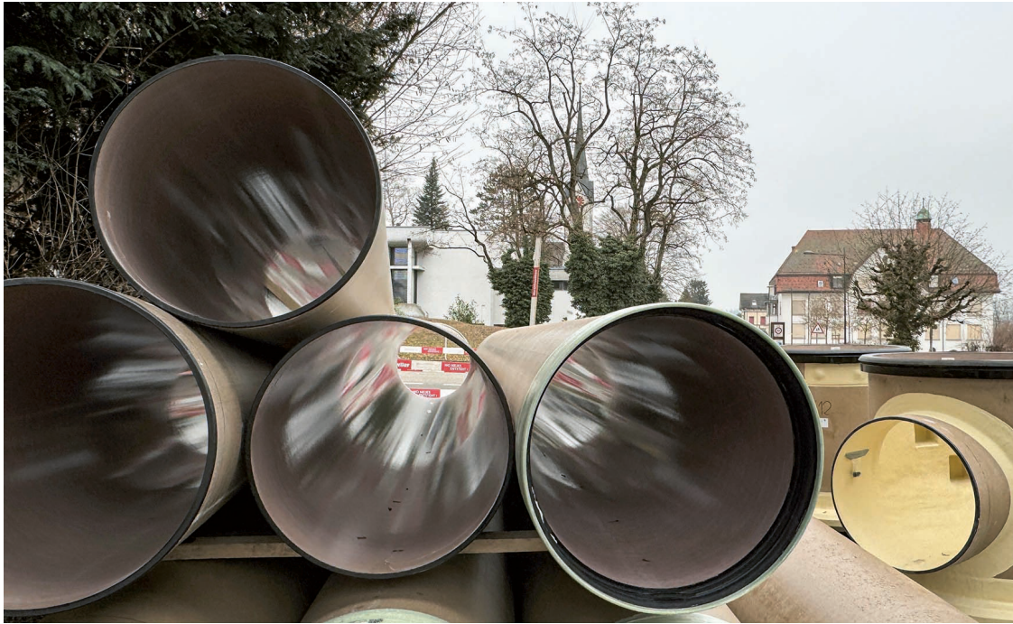
Rohre von einem Meter Durchmesser und gross dimensionierte Schächte halten künftig Regenwasser in der Sportstrasse zurück und leiten es dosiert in die Uze.
